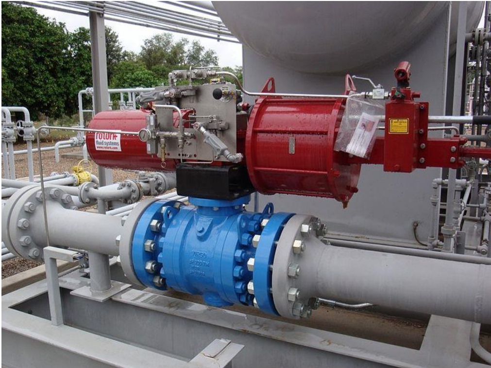
8.7. Ventili za nužno zatvaranje (Emergency shutdown valves)
